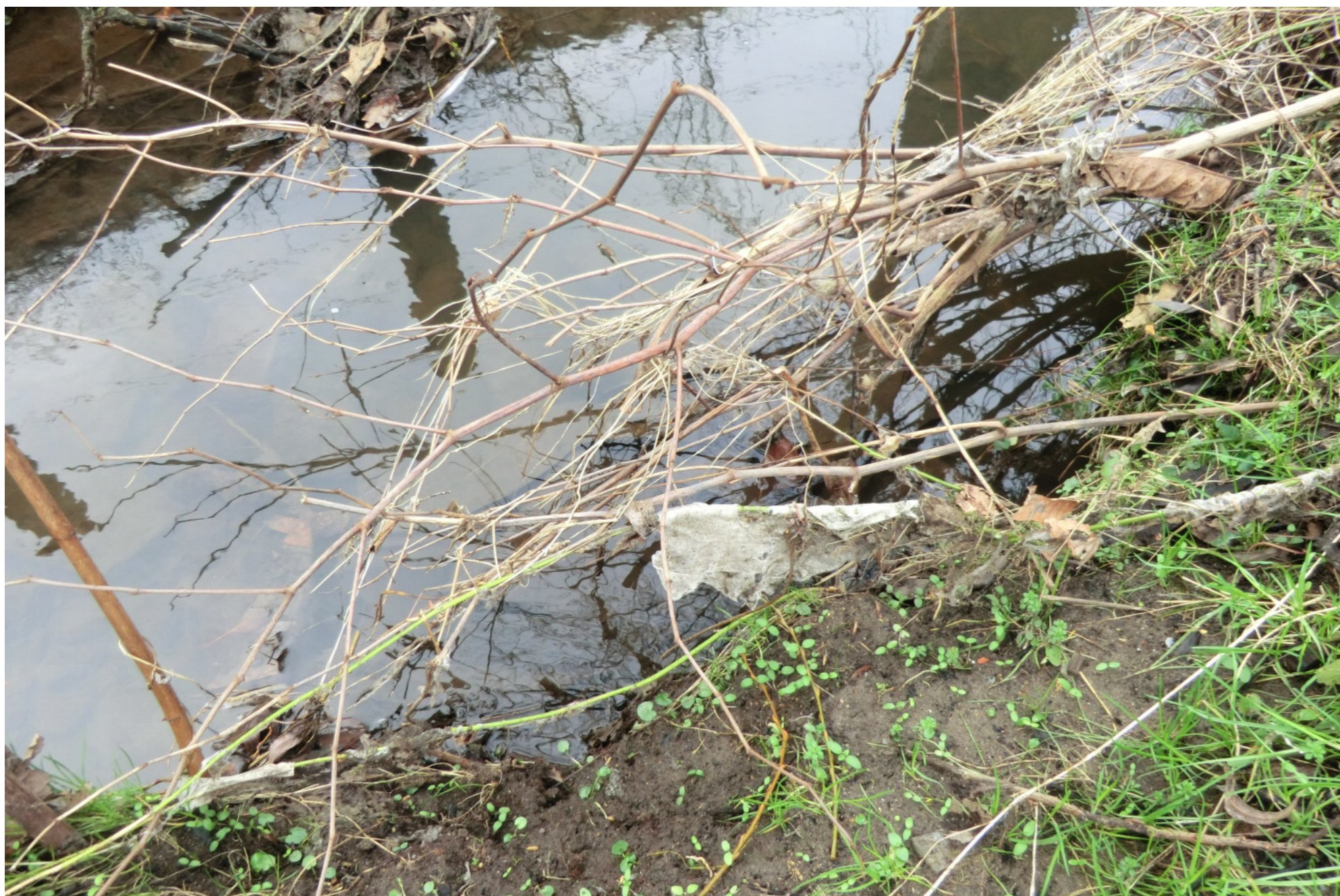
Bild 1: Rückstände von Mischwasserentlastungen im Uferbewuchs des Knöselsbachs
